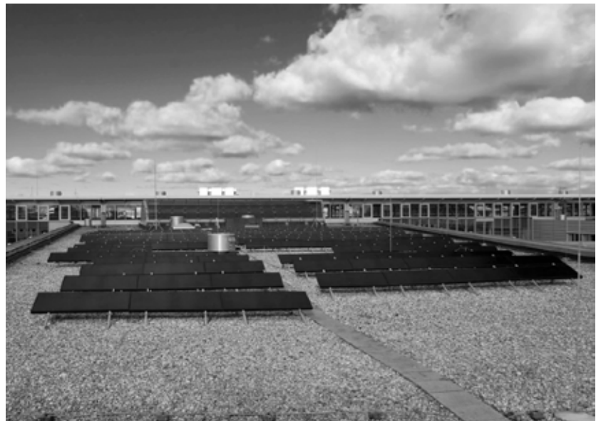
Eine der Photovoltaikanlagen auf dem MW-Gebäude. Der größte Teil der Dachfläche ist jedoch ungenutzt.
